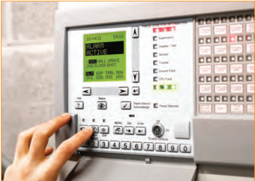
وحدة التحكم لنظام كشف الحرائق
